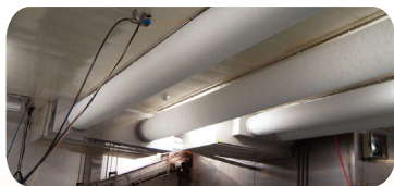
ソックダクト方式の空調システム
